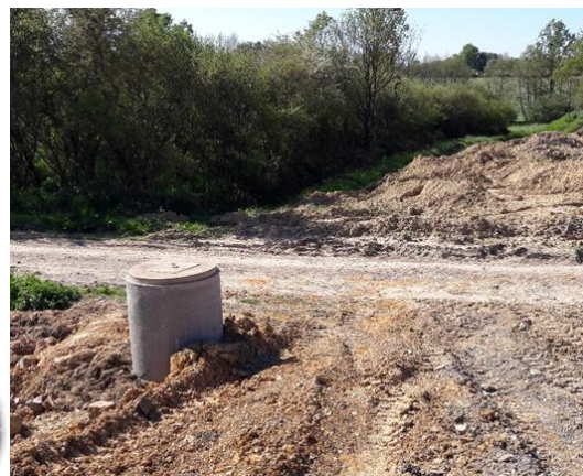
Enterrement de cours d'eau et remblai du lit majeur
